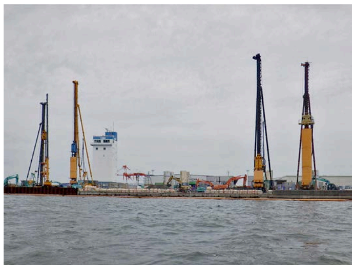
地盤改良(CDM・CDM-LODIC・エポコラム LOTO・エポコラム pls 工法)施工状況
