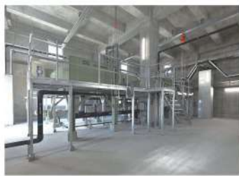
2階脱水・脱臭機室
